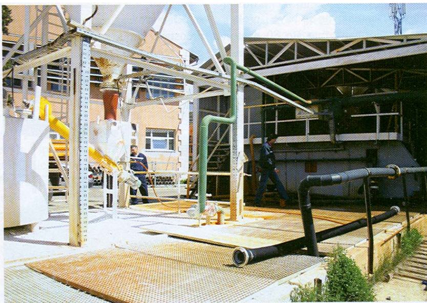
Uređaj za predtretman otpadnih voda u Adriacinku
