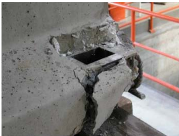
Slika 7. Oštećenja nosača na spoju sa stupom
