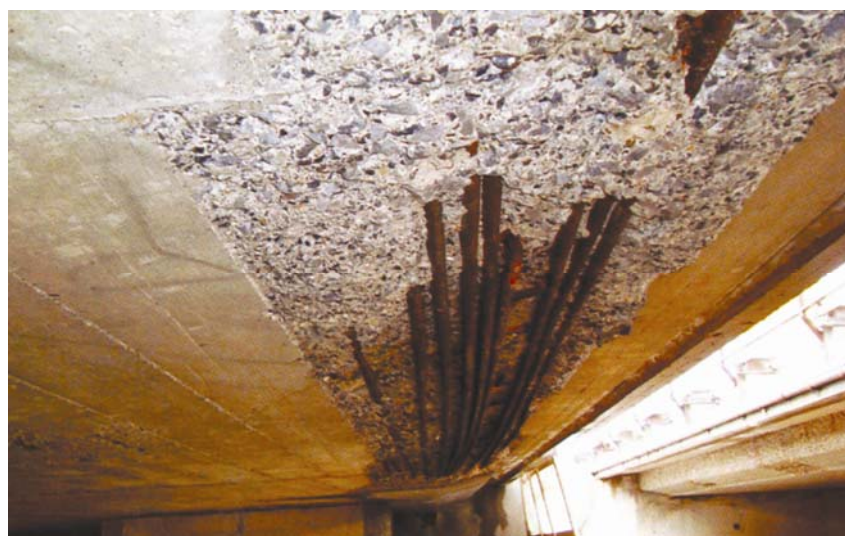
Oštećenja na podgledu armiranobetonske kolničke ploče
