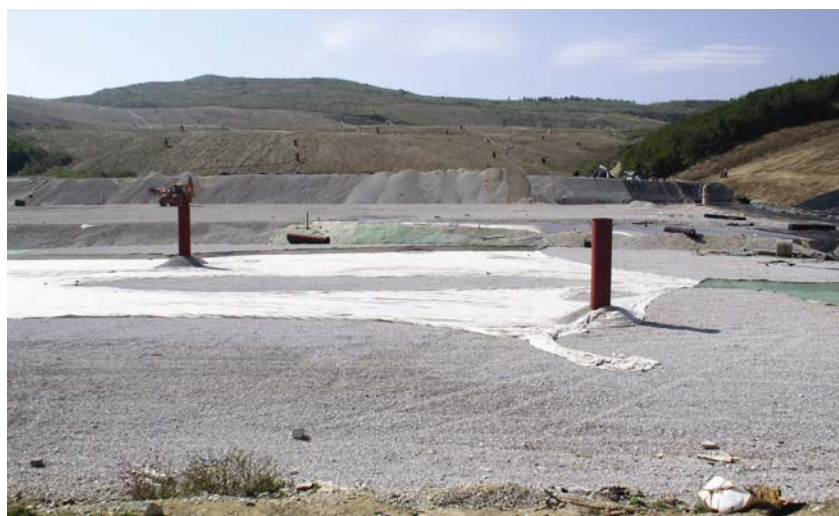
Sonde za otplinjavanje na odlagalištu Smiljevići
