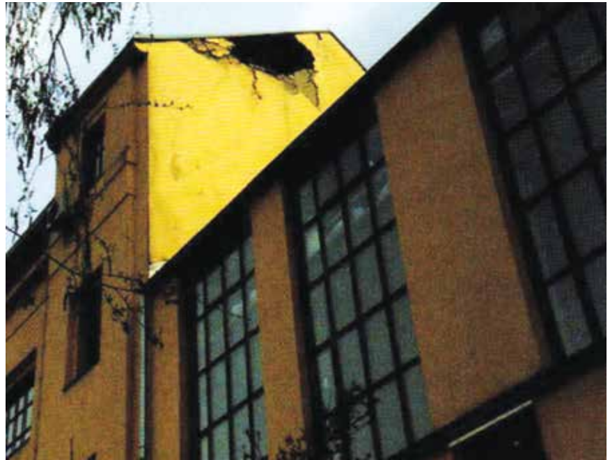
Oštećenje zabatnog zida zgrade u Ilici 85
