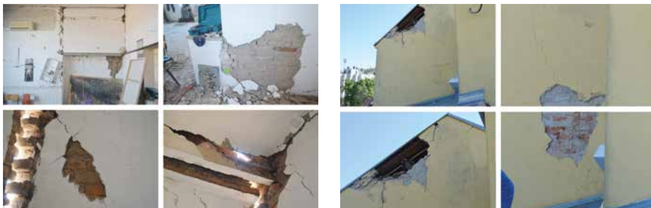
Oštećenja od potresa na zgradi u Illici 85
